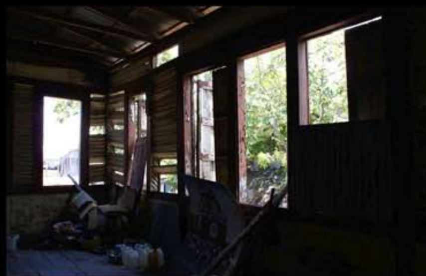
Etat de dégradation des ouvertures à l'étage
